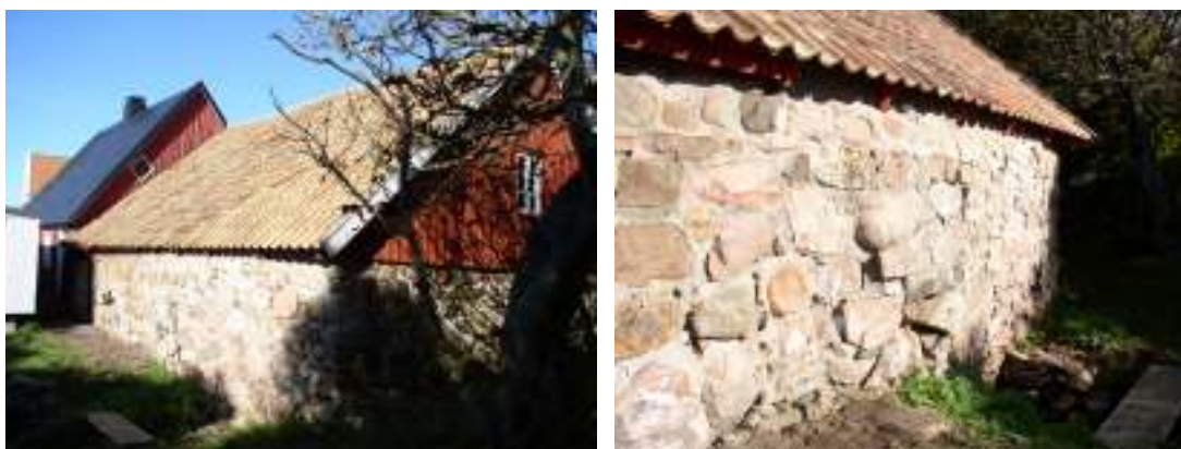
Kvarnens västra vägg. Kraftig utbuktning/utkalvning av stenar samt sprickbildning har skett c a fyra meter från det sydvästra hörnet
