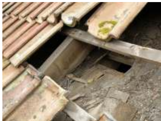
Detalj av det underliggande och skadade spåntaket.
