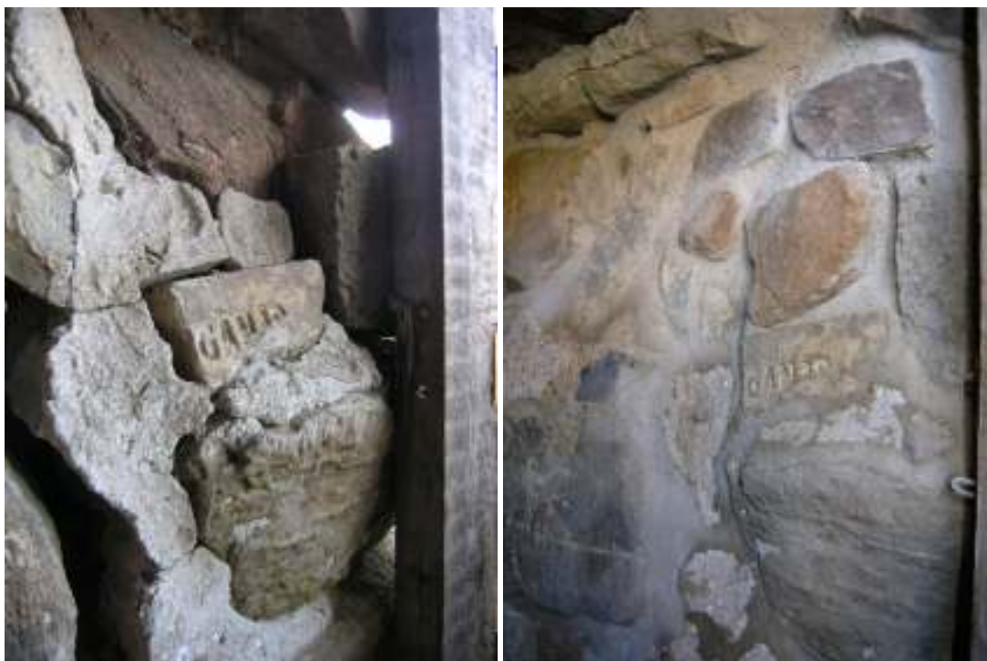
Skadat murparti innanför dörren i kvarnhuset.
