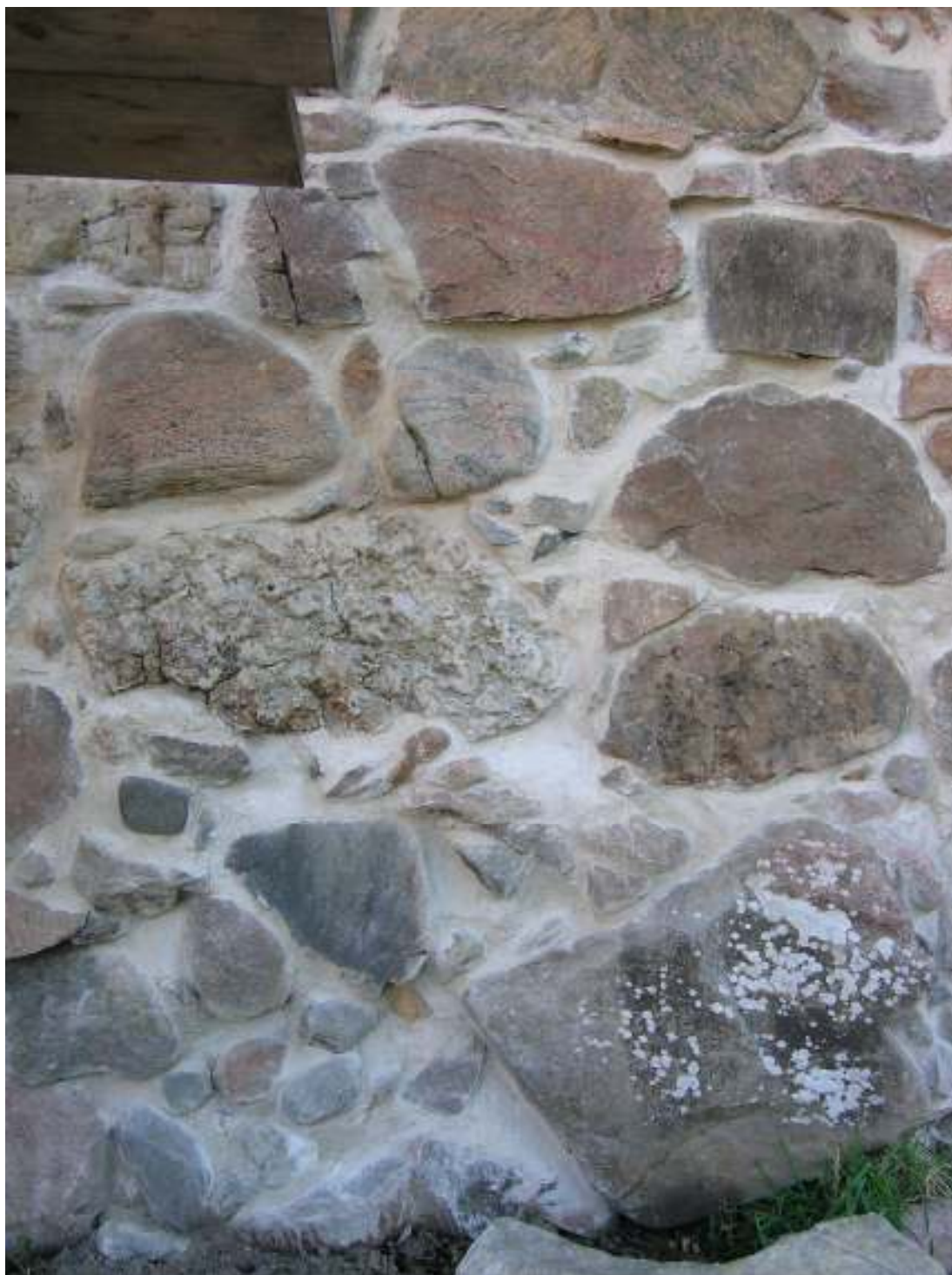
Naturstensmuren har efter nedknackning av cementfogar fogats om med kalkbruk. Längst ner är fuktvandringen stor och därför har man där använt ett hydrauliskt kalkbruk, vilket är starkare än ett rent kalkbruk. Jämfört med tidigare cementfogar har nuvarande fogar medvetet lagts längre in i muren, för att låta murens naturliga karaktär komma fram mer.
