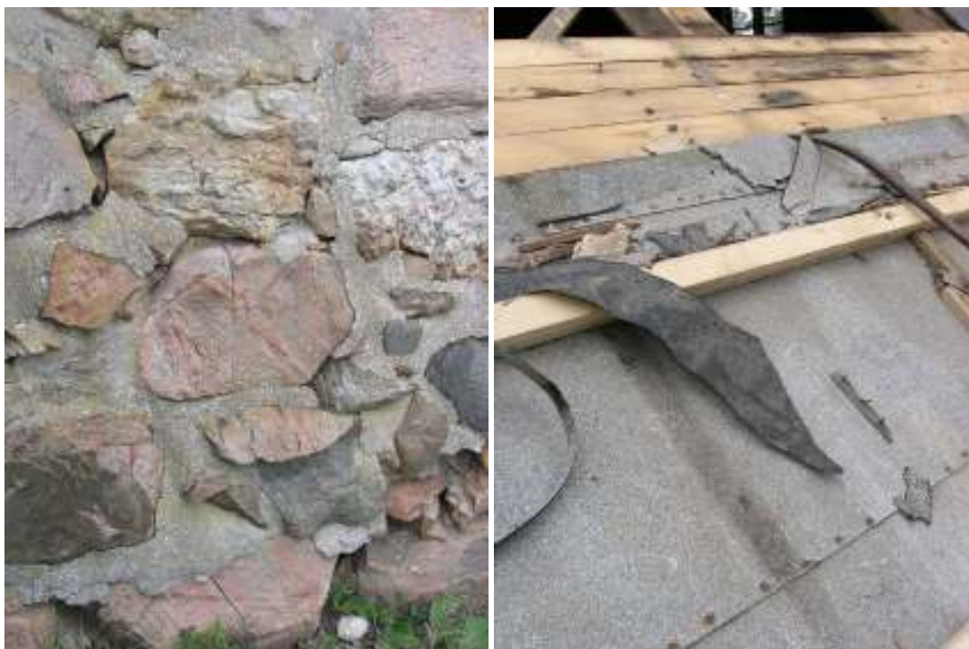
Naturstenssockeln med uppspruckna cementfogar.
